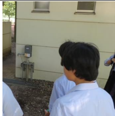
防災井戸ポンプ
