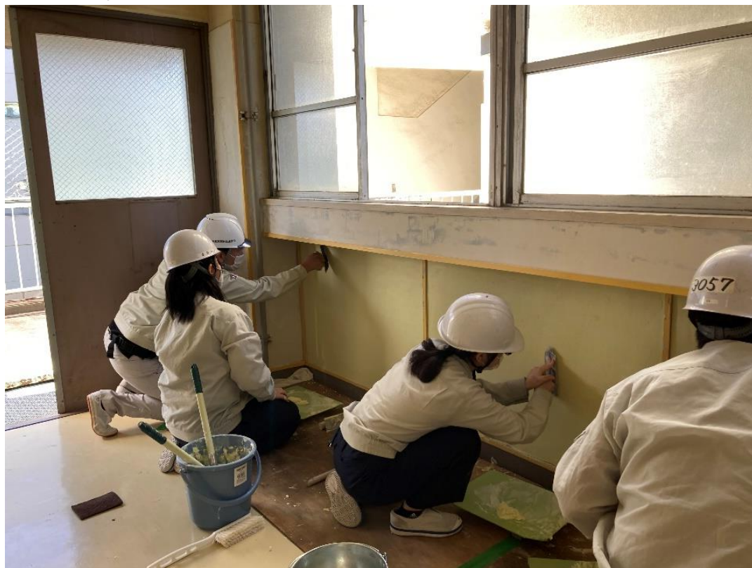
仕上げ塗り。もうすぐ完成になるよう平らな壁面を目指して塗ります。
