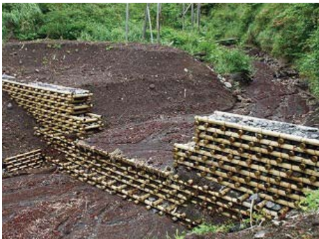
浸食を防止する床固工（三宅村）
