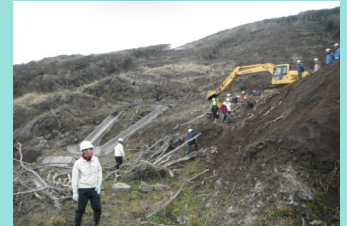
2013年の土砂災害被災地の様子
