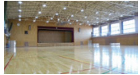
体育館 空調設置(2018)
