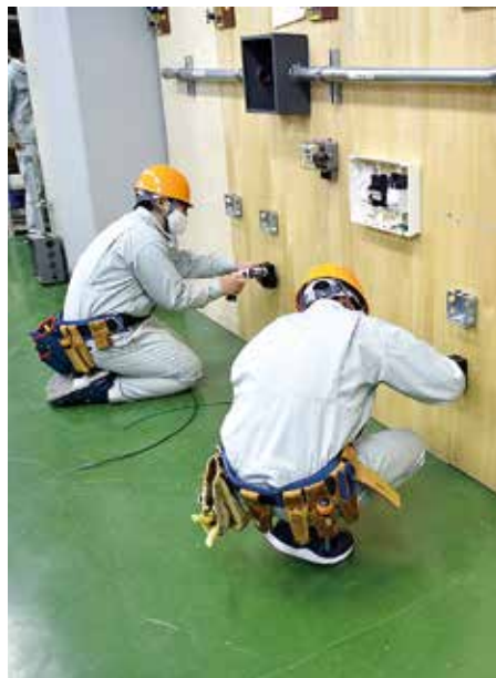
大規模電気工事
