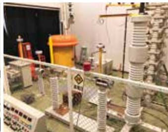
高電圧実験室
