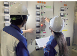
電気設備点検
